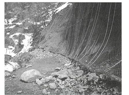
地山から崩壊した現場箇所
