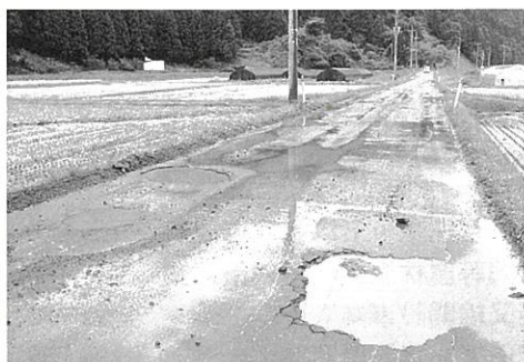
ひび割れた凍上災害箇所（大沢地区）
