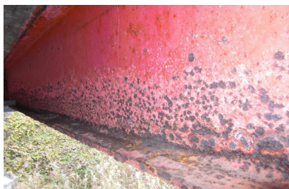
「防食機能が劣化した状態」
