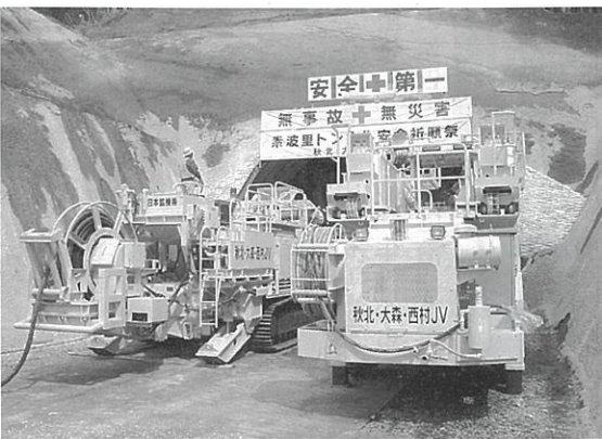
今年度からはトンネル工事 (林道米代線：粕毛字西熊の岱地内)
